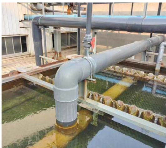
常安能源超滤反洗水回水改造
